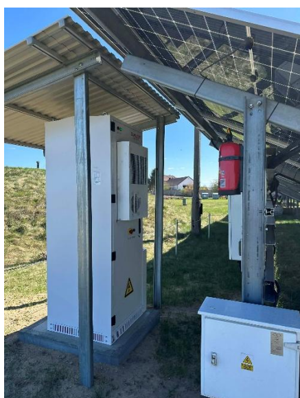
Magazyn energii na SUW Sypniewo
