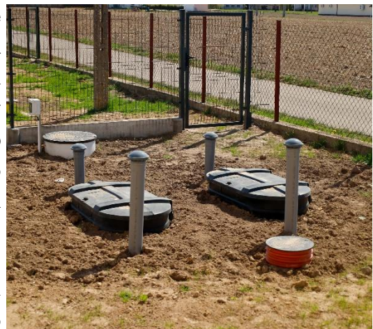
Oczyszczalnia ścieków przy ZPO Gąsewo Poduchowne.
